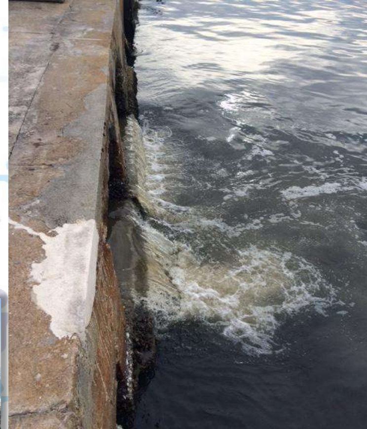
ICRJ/esgoto s/ tratamento
